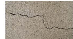
コンクリート表面のひび割れ
